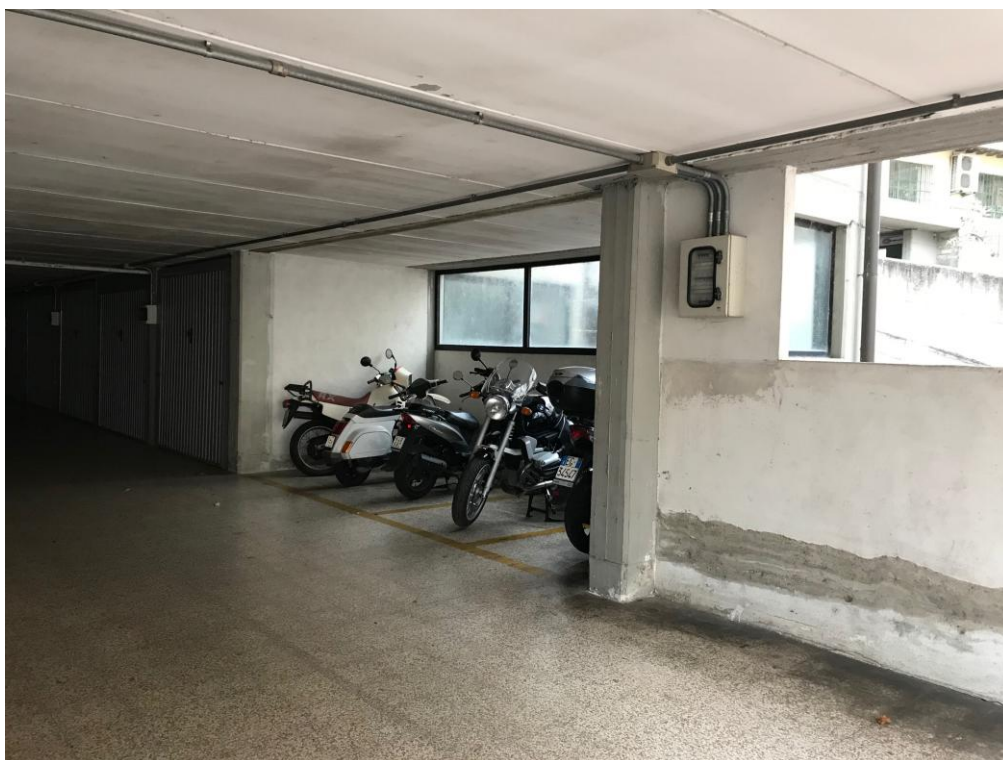
Foto 8 – posti moto – piano primo
